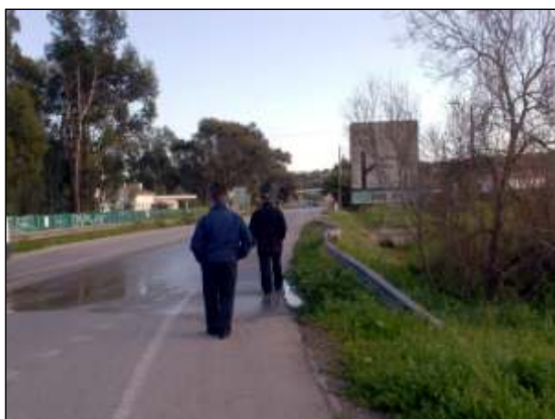
Rotura na EM 531-1 Junto à Igreja da Penina.
