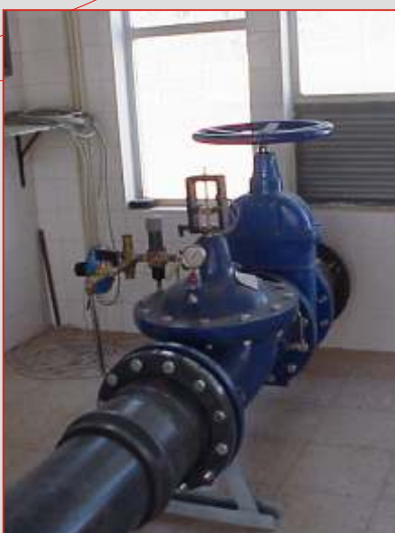
Válvula automática controladora de pressão e de enchimento da cisterna da Central da Figueira
